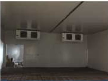
Cool Room ICS 200 Ton
