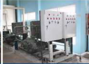
Generator Set 92,5 KVA (PPI Daruba)
